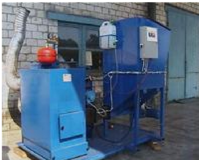
Fot. 2. Kocioł 5000 kW w Trzciance
