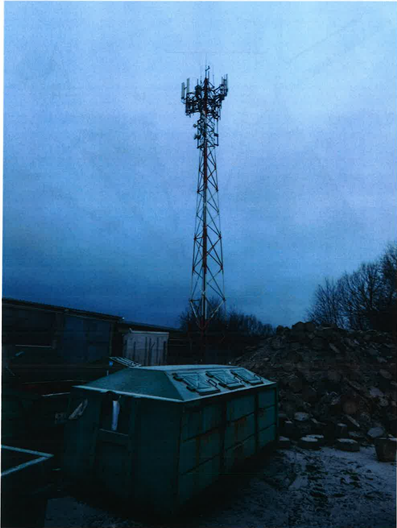
Załącznik nr 3 Instalacja Radiokomunikacyjna T-Mobile Polska S.A. 38843 (48843N!) GEB_MALBORK_DEGAULLEA Dokumentacja fotograficzna
